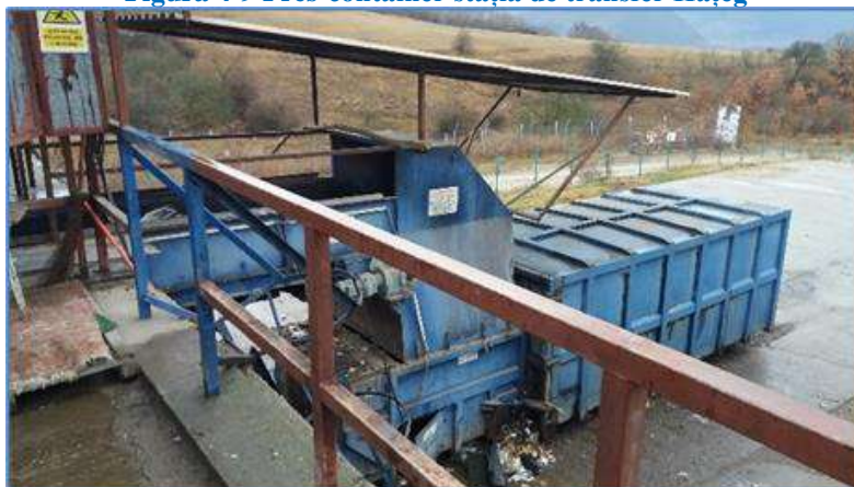
Figura 4-9 Pres-container stația de transfer Hațeg
