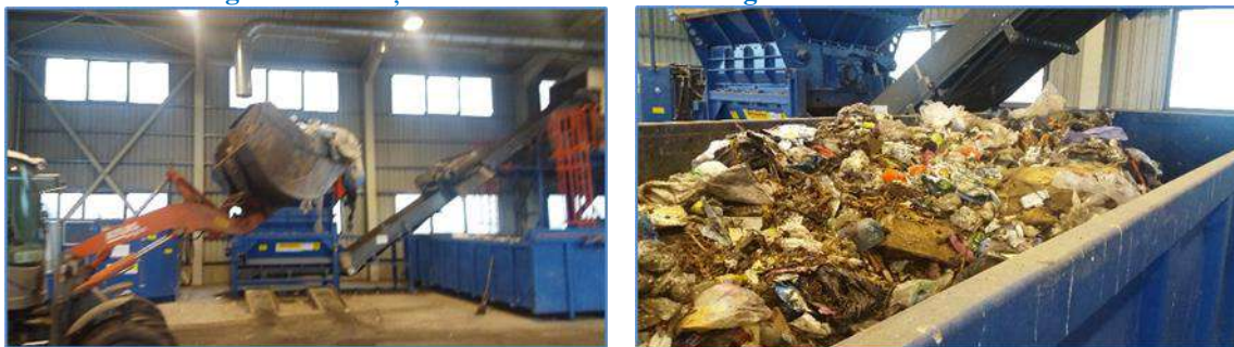
Figura 4-16 Stația de Tratare Mecano-Biologică CMID Bârcea Mare
