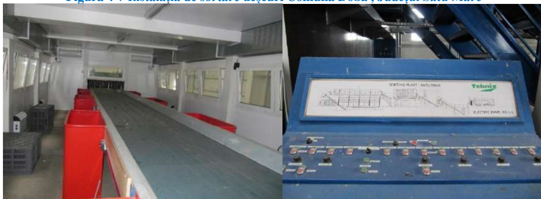
Figura 4-7 Instalația de sortare deșuri Comuna Doba , Județul Satu Mare
