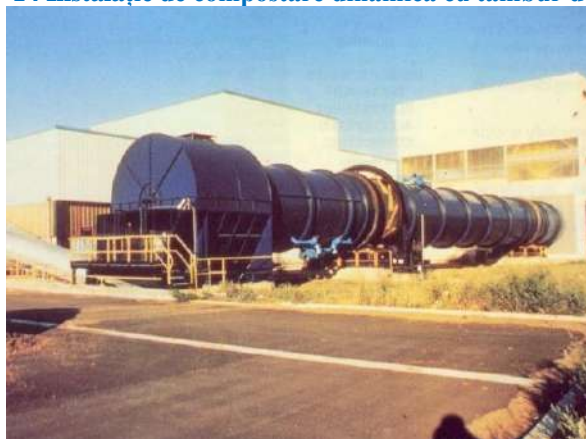
Figura 7-14 Instalație de compostare dinamică cu tambur de alterare
