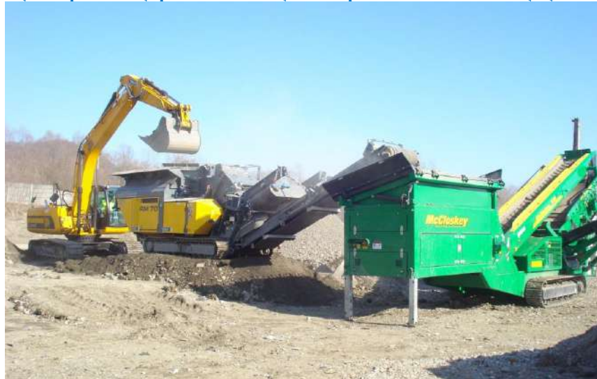
Figura 4-12 Stația de preluare și prelucrare a deșeurilor provenite din construcții și demolări – Medias
